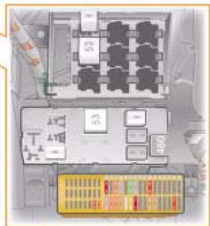
Sicherungsbox unter der Schalttafel links
